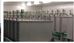
溶媒抽出装置
